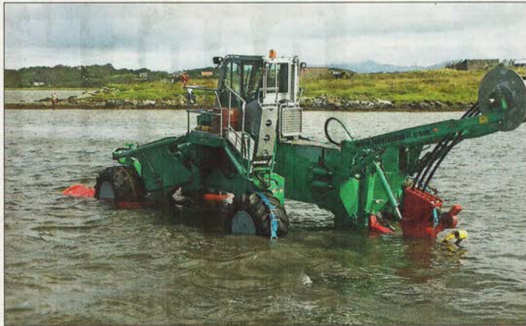
Ein mit Spezialreifen und Gleitkufen ausgestatteter Spezialpflug verlegt das Seekabel in den Meeresgrund.
